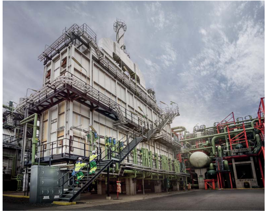
Eine gut geplante und effizient ausgeführte Abschaltung sorgt für einen sicheren und zuverlässigen Prozess bis zum nächsten geplanten Stillstand. (Foto: Metso)
