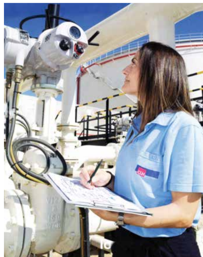
MOV Gate Valve auf CLH-Anlage in Spanien
